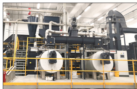
圖 3 進行脫氣作用的蒸汽鍋爐
